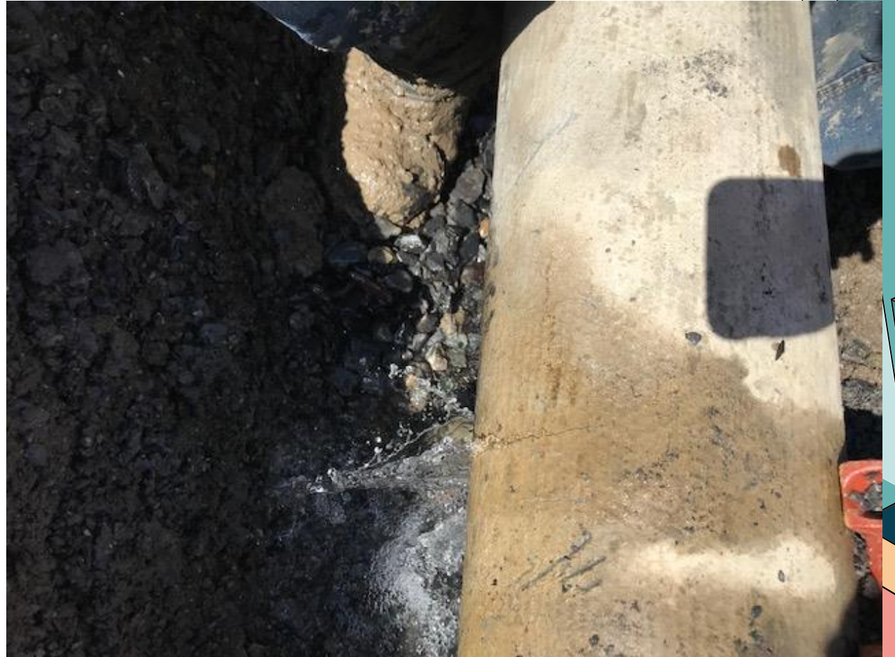
Conduite en ciment-amiante fissurée
