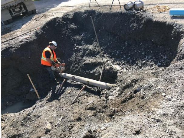
Bris d'aqueduc - 18 septembre 2019
