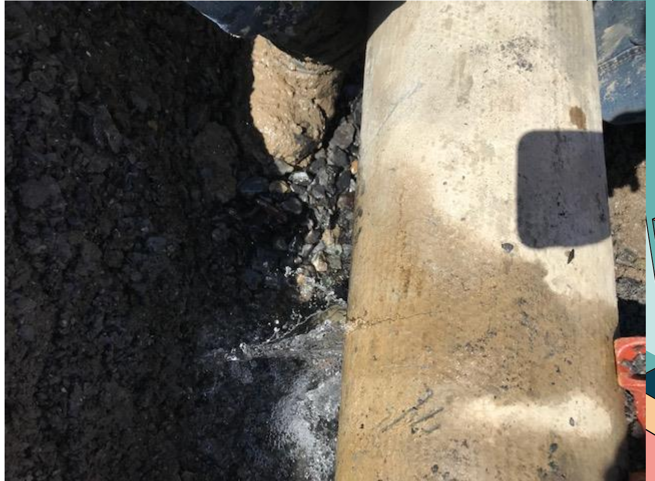
Conduite en ciment-amiante fissurée
