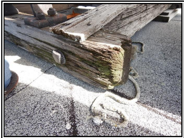
C-50 : Assise de la cloche détériorée (2023)
