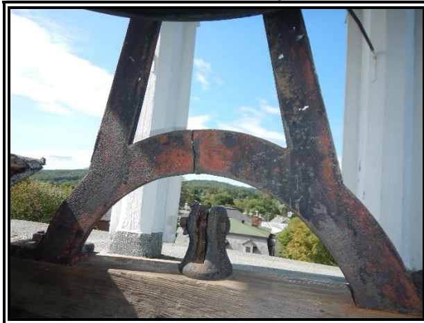
C-55 : Structure de la cloche fissurée (2023)
