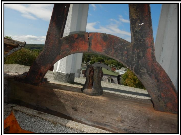
C-56 : Structure de la cloche fissurée (2023)
