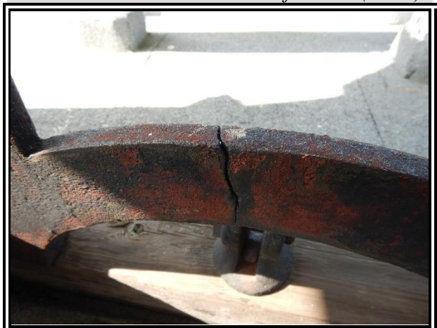
C-58 : Structure de la cloche fissurée (2023)
