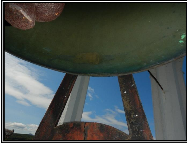
C-53 : Structure de la cloche fissurée (2023)
