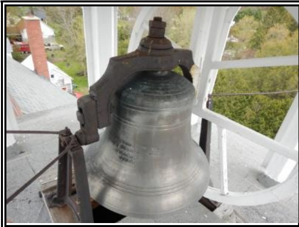
C-51 : Assise de la cloche détériorée (2023)
