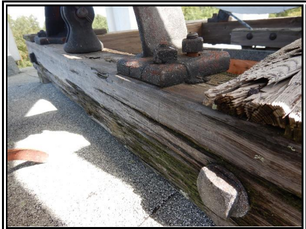
C-52 : Assise de la cloche détériorée (2023)
