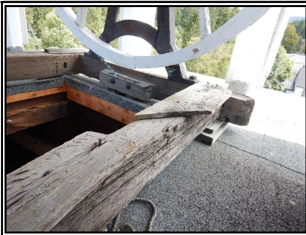
C-49 : Assise de la cloche détériorée (2023)
