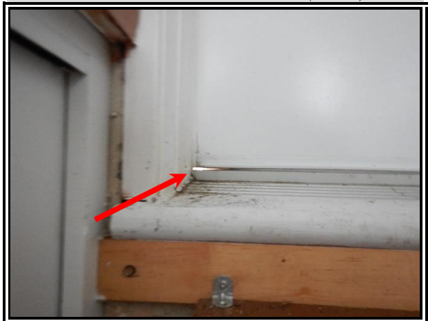
C-98 : Façade droite : Lumière du jour perceptible au bas de la porte arrière donnant dans la cuisine du sous-sol (2023)
